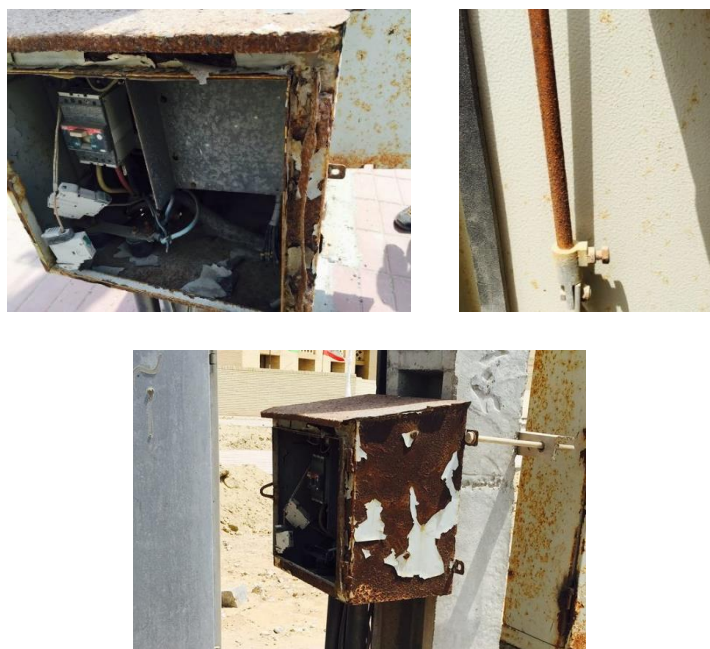
شکل (۱) خوردگی یکنواخت در تابلوهای برق
